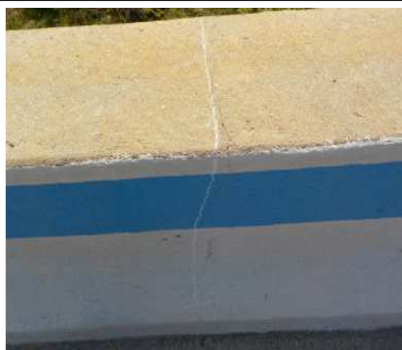
난간 S17 방호벽 균열(폭:0.2mm)
