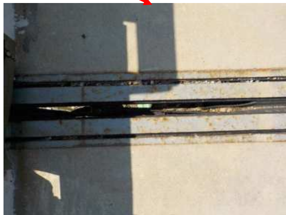
③ 신축이음 P12 본체 고무재 파손
