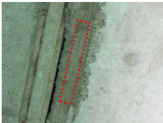
① 바닥판하면 S12 보수부 철근노출
