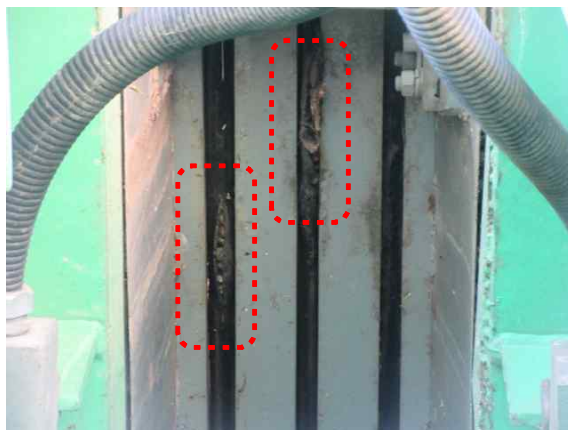
② 신축이음 P12 고무재 파손
