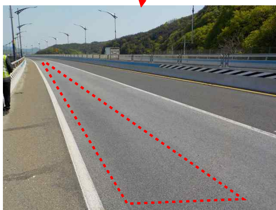
④ 교면포장 S18 아스콘 소성변형
