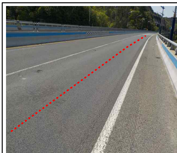
교면포장 S13 아스콘 균열
