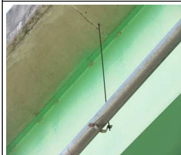
배수시설 S13 배수관 연결볼트 탈락
