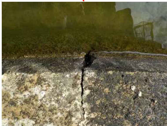
② 교각 P11 기초 파손
