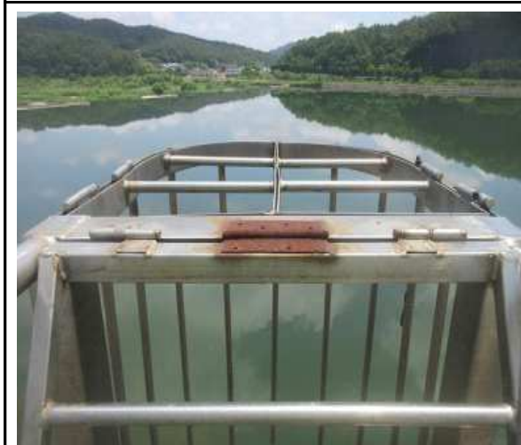
점검시설 P3 출입문 연결부 부식
