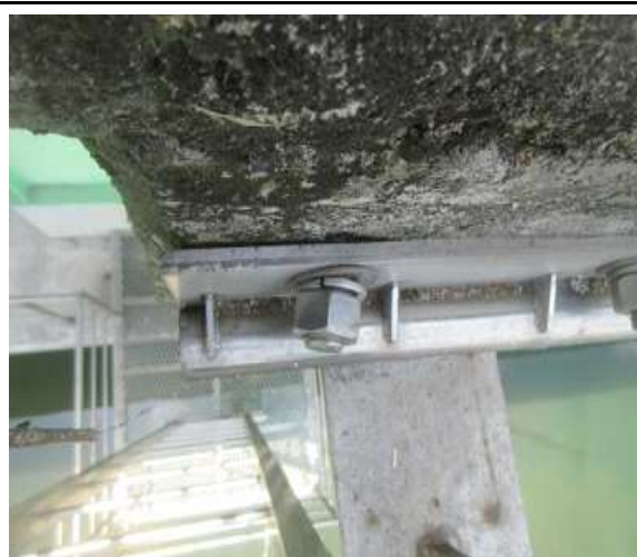
점검시설 P6 점검사다리 브라켓 볼트풀림(#4-1)
