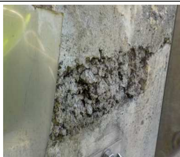
난간 S7 방호벽 외측 파손
